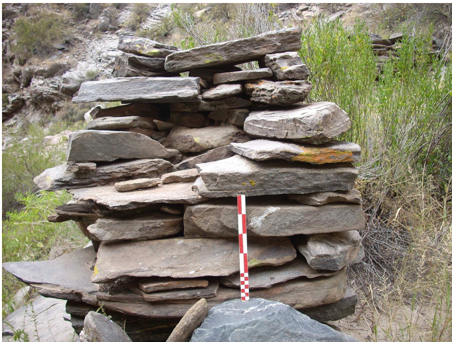
Figura 4. Corte del muro Sur del R37, MF1, sector I, donde se aprecia la técnica constructiva de doble lienzo con trabazón.
